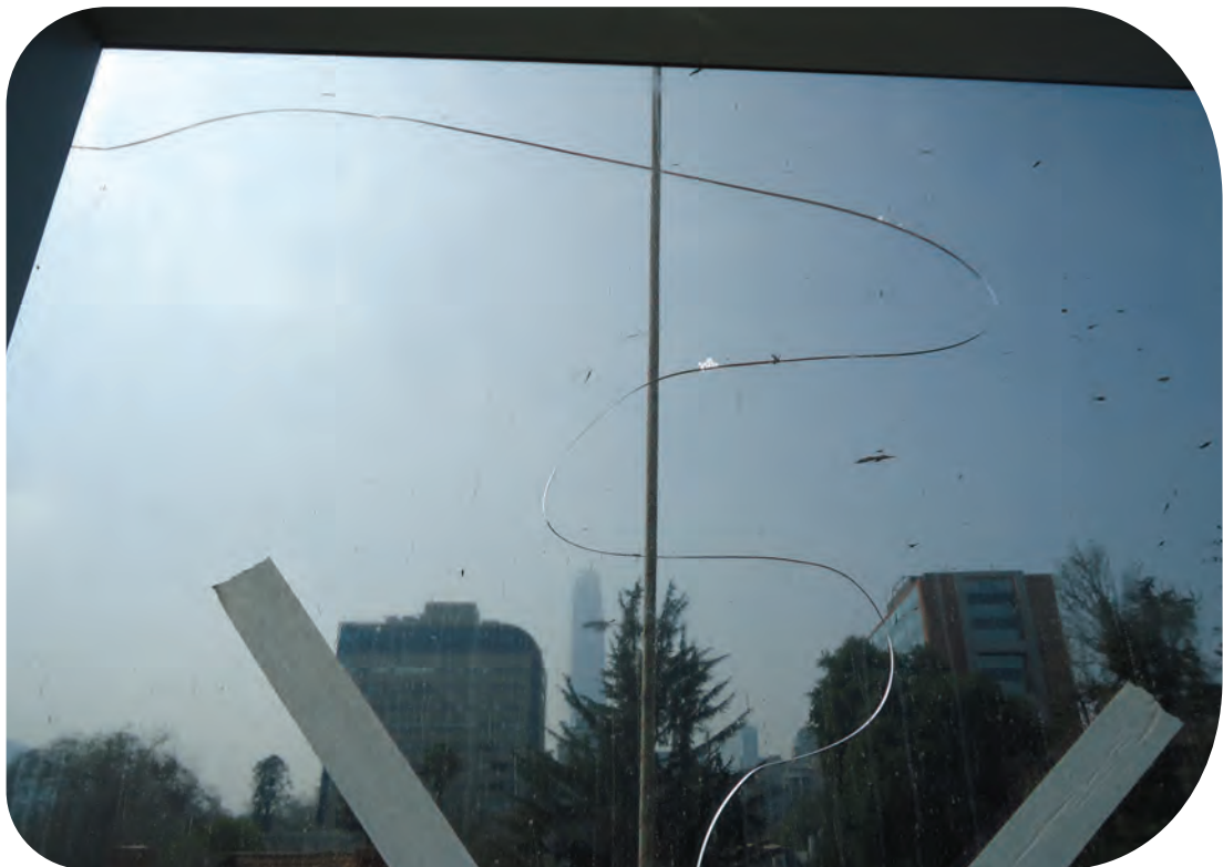
Fractura por estrés térmico.
